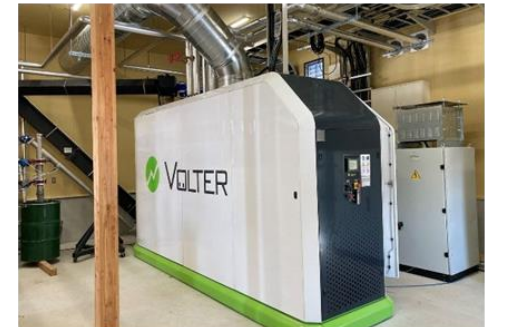
熱電併給設備導入 熱も電力も産み出し有効活用
